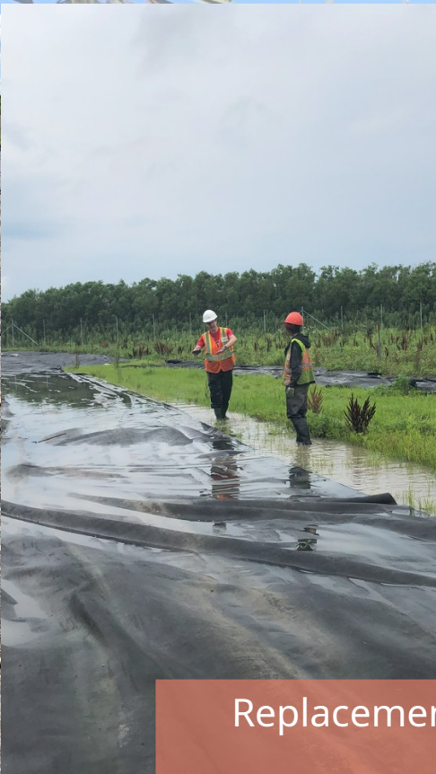
Membrane déplacée par le vent, Barres d'armatures arrachées
